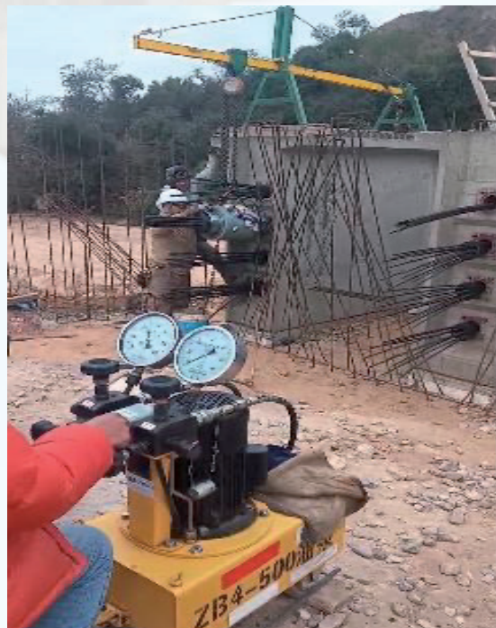
Trabajos preparatorios con el colocado del gato hidráulico – operando en el postensado
