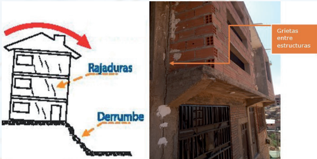
Figura 6. Derrumbe y aparición de grietas.
