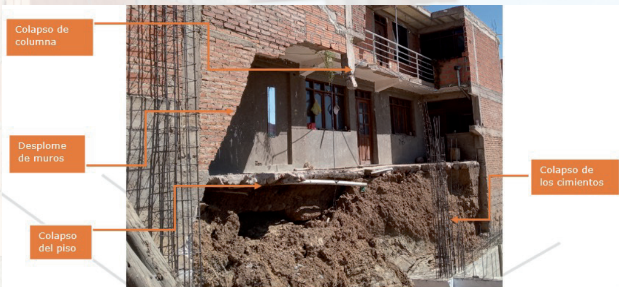
Figura 5. Colapso de la parte colindante de la vivienda
