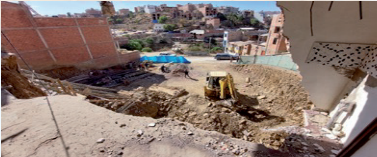
Figura 3: Colapso de la estructura mientras trabaja el equipo pesado
