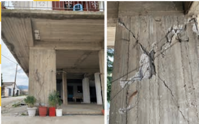
Figura 4. Severos daños en un muro de corte luego de un terremoto. (Sarhosis et al, 2022)
