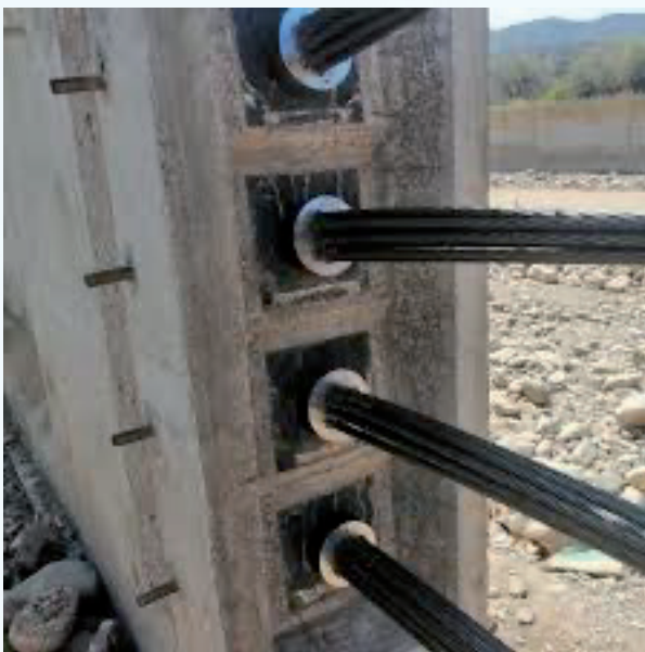
Colocado de viga sobre estribos – vista de anclajes y cables para postensado
