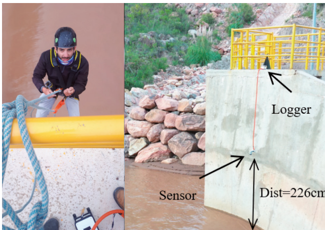
Figura 2 Proceso de instalación de los sensores Arduino.
