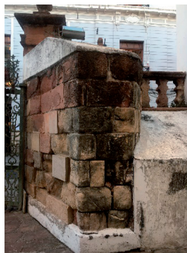
Fig. 3. Fachada principal (Vista interior) con costras negras y erosión.
