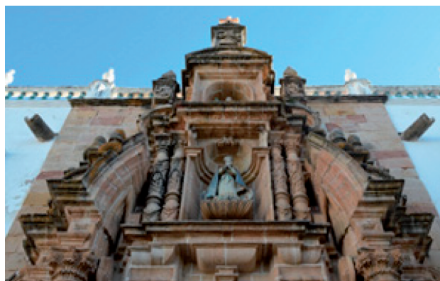
Fig. 2. Fachada lateral con patinas de envejecimiento, pátinas bióticas y líquenes.
